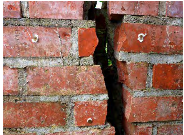
Spezialmesspunkte, Mauerschäden Frickenhausen
