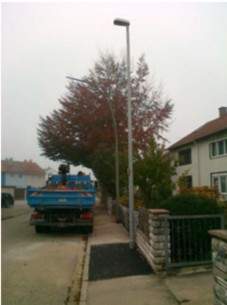
Moderne LED-Lampe in der Beethovenstraße. Im Hintergrund der alte Lampenmast
